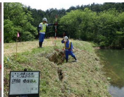
池袋ため池(法面崩落)
