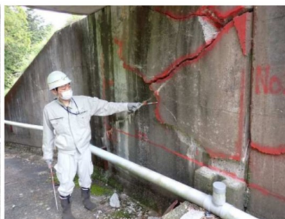
石の宮ため池(洪水吐破損)
